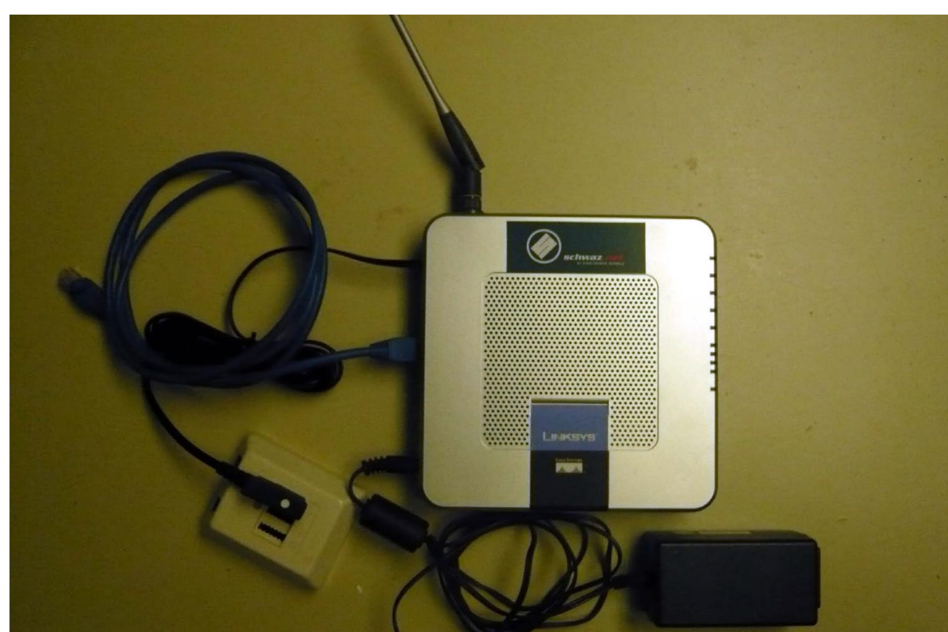
Anschlussbox für Telefonie und Internet an das Leitungsnetz der Post.
